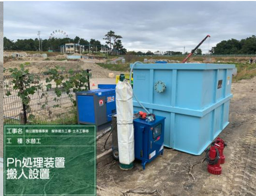
PH 処理機設置状況
