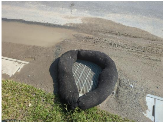
フィルターソックス設置状況
